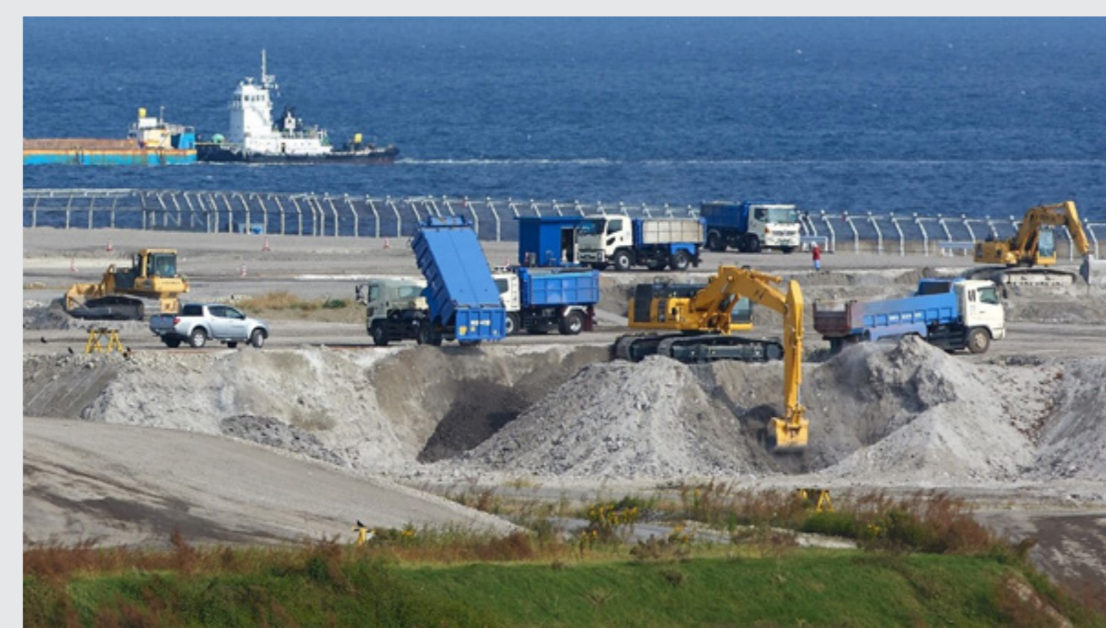
廃棄物埋立処分場 (東京都) 東京都環境局
