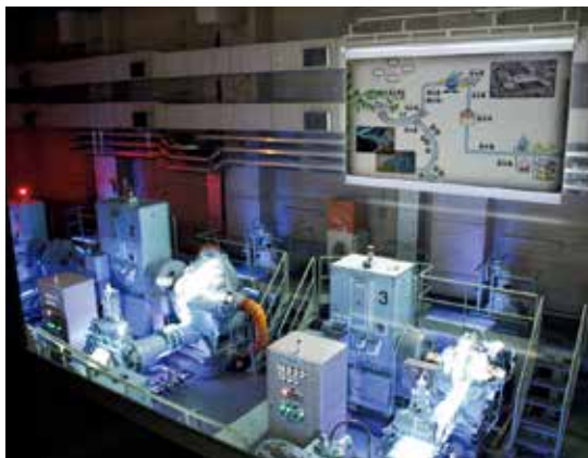
水の科学館地下にある給水施設「有明給水所」の様子
